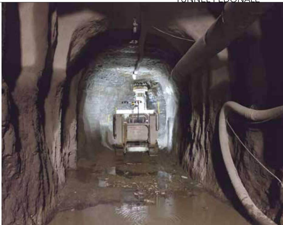
1. La galleria pedonale è lunga 80 m, larga 4 e ha un fronte di scavo di circa 20 m 2
